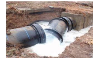
東日本大震災における継手離脱
